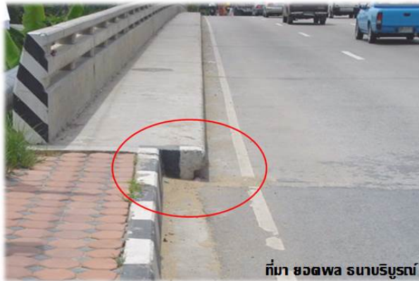
รูปที่ 3.40 หน้าตัดถนนไม่สม่ำเสมอ โดยไหล่ทางแคบลงกะทันหันในช่วงเชิงสะพาน
